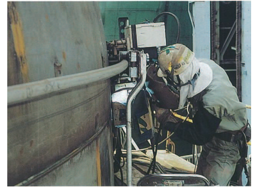
液化石油气储罐的典型应用
